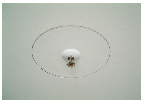
Ümmargune luuk koos sprinkleriga (sprinkler sisseehitatud töömaal)
